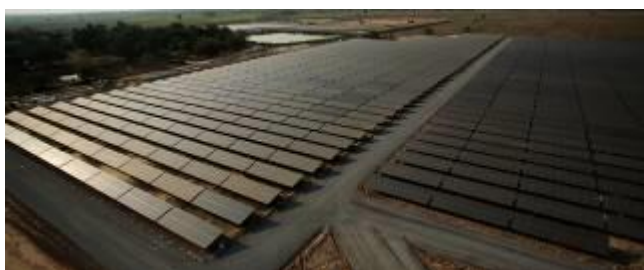
โซลาร์ฟาร์มแบบ Photovoltaics
