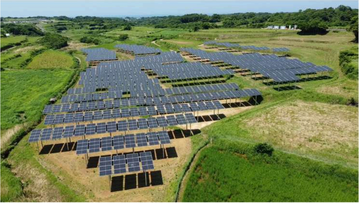
โครงการ Ukujima Mega Solar ณ เมืองซาเซโบ จังหวัดนางาซากิ ประเทศญี่ปุ่น
